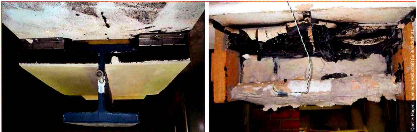
Abb. 6: Stahlträgerquerschnitt und -ansicht mit reaktivem Brandschutzanstrich und Foamglas-Dämmung am oberen Flansch – vor und nach dem Brandversuch nach DIN 4102-2
